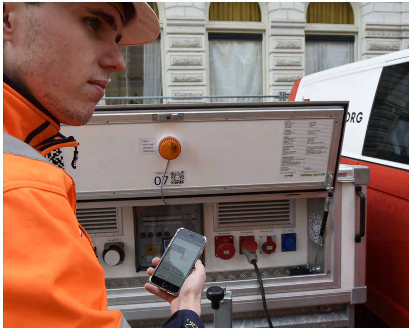
Einige unserer Turmdrehkräne laufen einen ganzen Tag lang mit Strom aus einem Akkswagen oder Baustrom.
